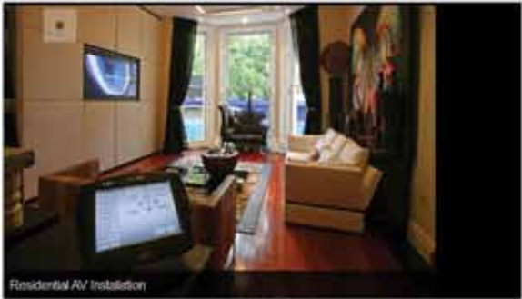
Residential AV Installation
